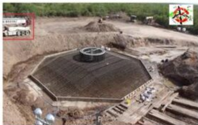
El impacto de las enormes cimentaciones (412 m 2 / 25 m. de diámetro) de estos gigantes de 200 metros provocan la deforestación de amplias zonas de alto valor medioambiental.
