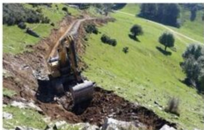
Las enormes pistas, para el transporte de los molinos y el acceso a los mismos, que se deben construir provocan enorme pérdida de masa forestal, de biodiversidad y la fragmentación de los hábitats.
